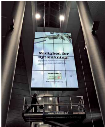
Den frithængende skærmløsning, der er monteret i lufthavnens loftskonstruktion, er et imponerende syn.
